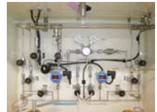
ガス供給設備
