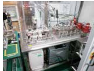
高压試験設備
