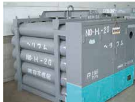
ガスカードル
